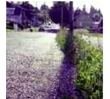
Toleranzgrenze 2: Hier ist der Wasserabfluss behindert, weil ein regelmässiger Unterhalt fehlt.
