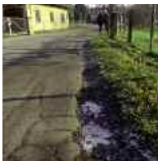
Die Hauptursachen für Schäden an Verkehrsflächen sind Frost und der Verkehr.
