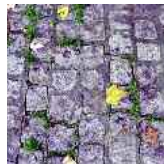
In Zement verlegte Pflästerungen sind anfällig für die Rissbildung, was das Einwachsen von Pflanzen begünstigt
